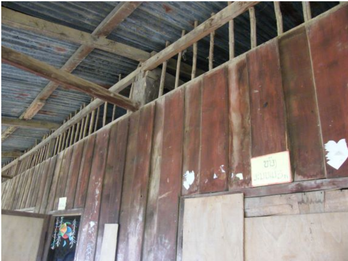
Sous les tôles ondulées la chaleur est insupportable. Les poutres commencent à être rongées par les termites
