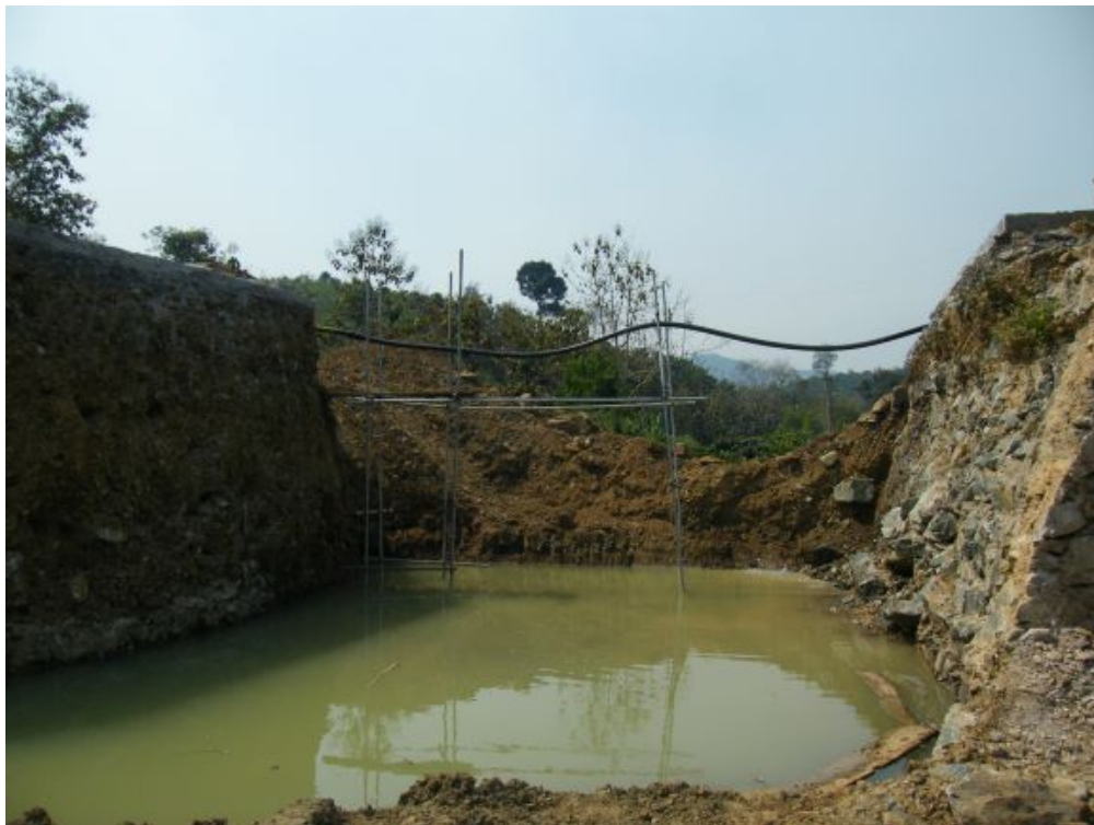
La piste d'accès au barrage a été emportée. Les chinois n'avait pas prévu les évacuations des pluies torrentielles sous la piste
